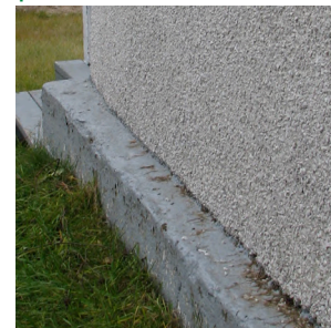
fondation plus large que les murs
