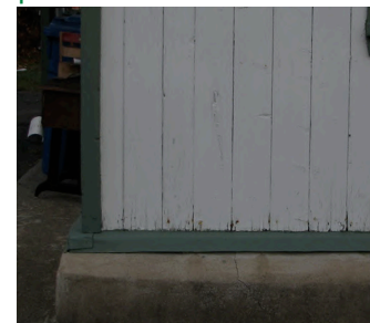
fondation plus large que les murs
