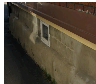
fondation plus large que les murs
