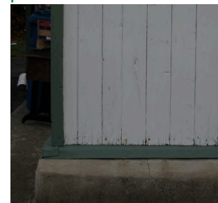
fondation plus large que les murs
