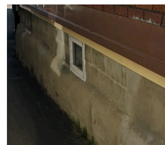
fondation plus large que les murs
