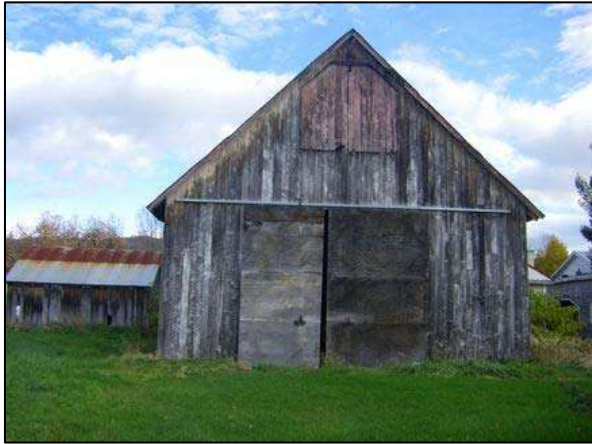
Portes coulissantes abritant l'entrée de la grange située au 98, rue Ambroise-Fafard, Baie-Saint-Paul.
