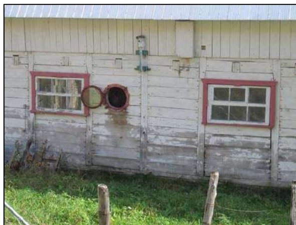
Assemblage à tenons à coulisses blanchis, visible au 636, rue Principale, Petite-Rivière-Saint-François.
