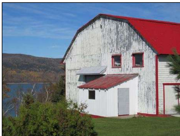
Planches cornières permettant la transition entre deux types de matériaux, à l'angle de la structure, visible sur la grange située au 1224, chemin des Coudriers, L'Isle-aux-Coudres.
