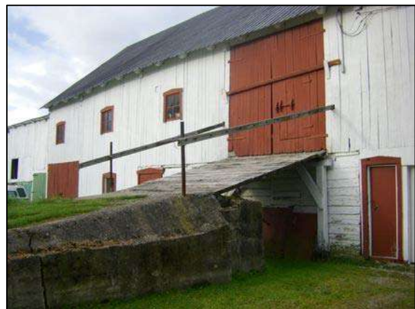
Pont de bois précédé d'une rampe en béton, situés au 1047, boulevard Monseigneur-De Laval, Baie-Saint-Paul.
