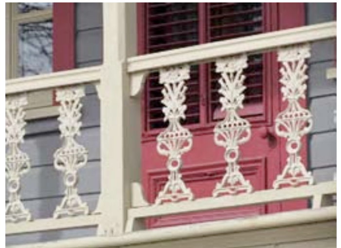
Garde-corps dont les barreaux sont constitués de fins éléments en fonte moulée. 82, rue Saint-Jean-Baptiste, Baie-Saint-Paul. IMG_3491.jpg
