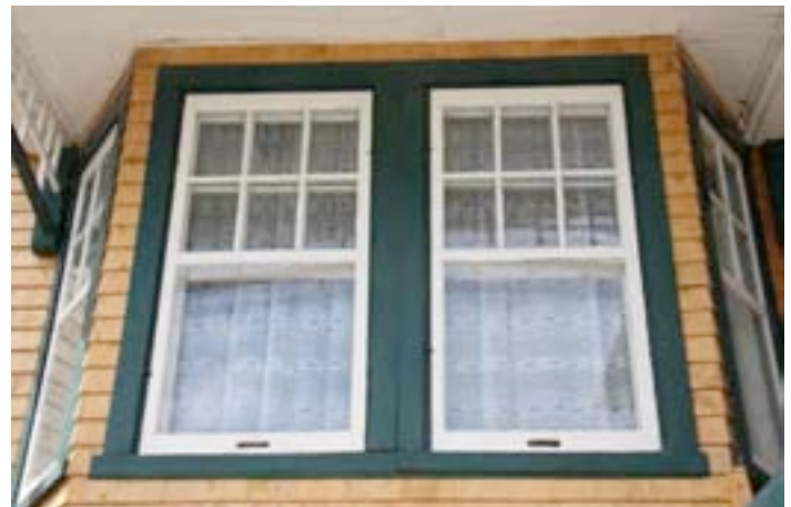
Modèle peu fréquent de fenêtres à guillotine jumelées à petits carreaux. Elles sont très bien préservées. 868, rue Principale, Petite-Rivière-Saint-François.
