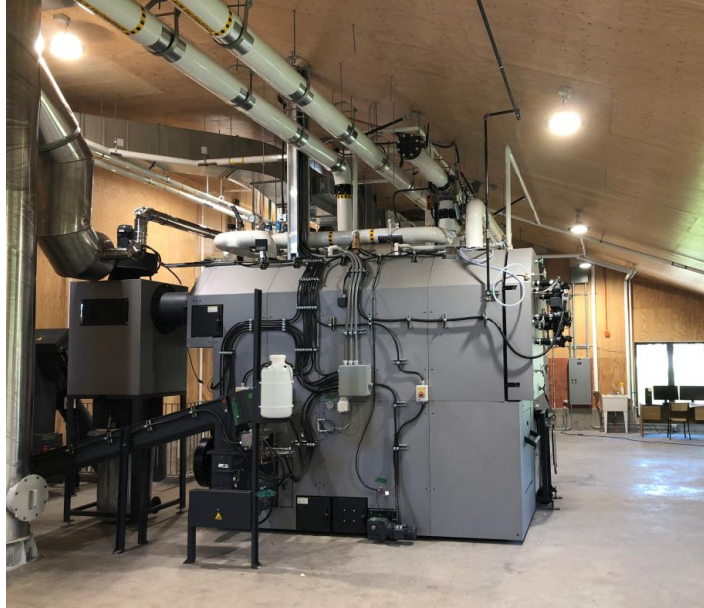
Figure 4 : Vue intérieure de la centrale
